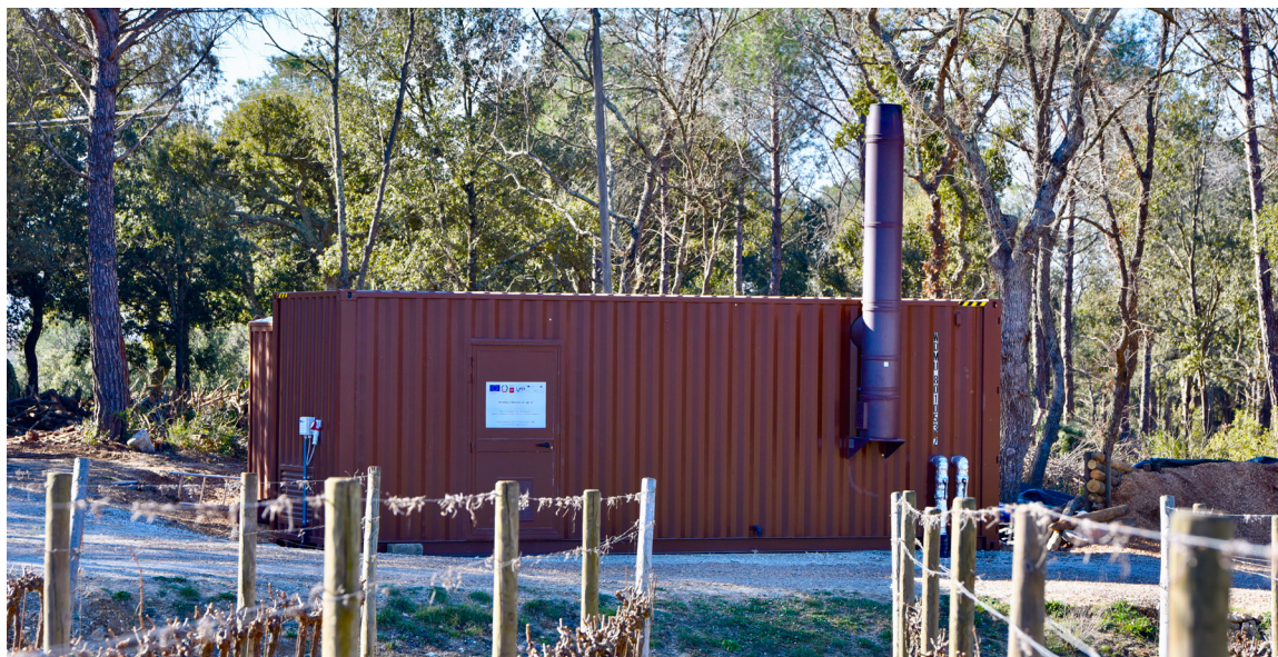
Caldaia a biomassa
